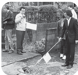
← 道路の陥没と水路への転落防止の改良が必要。
